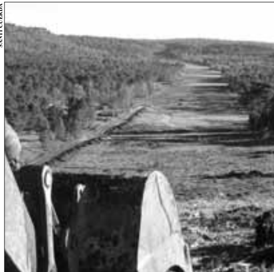
Las obras del AVE Madrid-Valencia a su paso por la Serranía Media de Cuenca están provocando una importante afeción sobre los bosques
